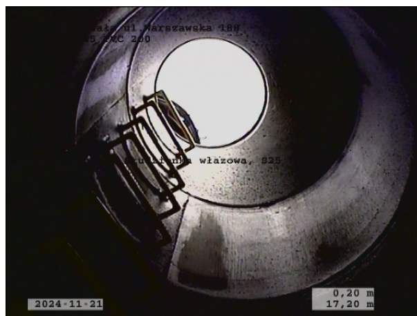
Zdjęcie: 34_2A, 00:01:30 17,2m, Węzeł końcowy, Studzienka włazowa, S25
