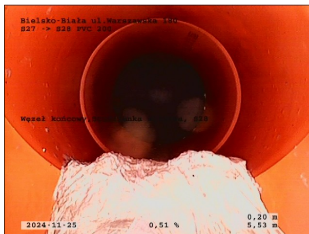
Zdjęcie: 46_2A, 00:01:16 5,53m, Węzeł końcowy, Studzienka włazowa, S28
