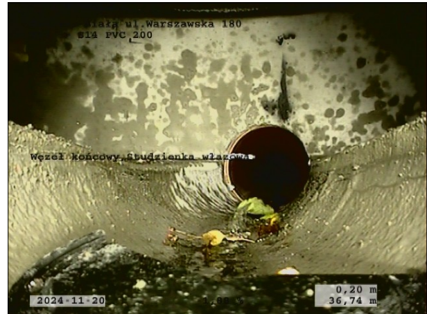
Zdjęcie: 13_2A 36,74m, Węzeł końcowy, Studzienka włazowa, S14
