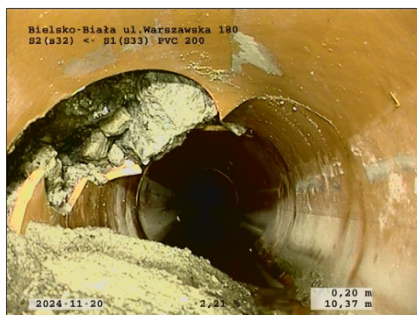
Zdjęcie: 2_2B, 00:01:02 10,37m, Rezygnacja z inspekcji, Przeszkoda
