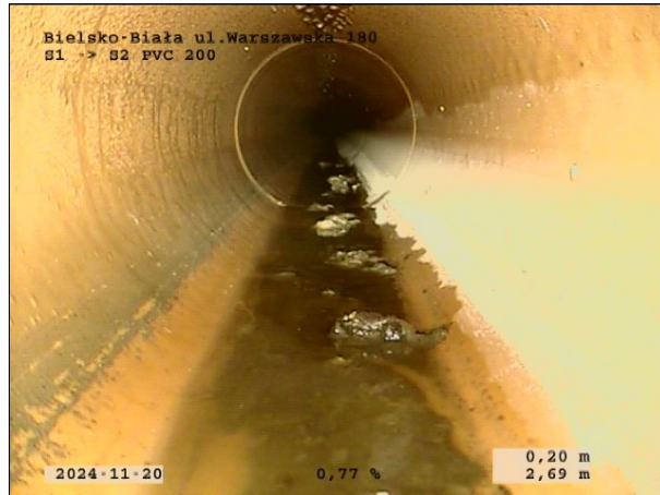
Zdjęcie: 1_1A, 00:00:00 0,2m, Węzeł początkowy, Studzienka włazowa, S1
