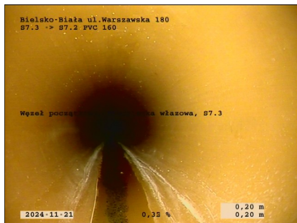
Zdjęcie: 21_1A, 00:00:00 0,2m, Węzeł początkowy, Studzienka włączowa, S7.3
