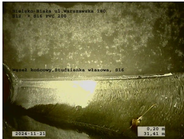
Zdjęcie: 19_2A, 00:02:18 31,41m, Węzeł końcowy, Studzienka włazowa, S16
