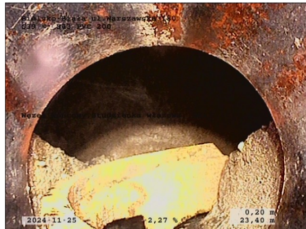
Zdjęcie: 53_2A, 00:01:58 23,4m, Węzeł końcowy, Studzienka włazowa, S43
