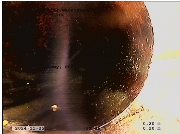
Zdjęcie: 55_1A, 00:00:00 0,2m, Węzeł początkowy, Studzienka włazowa, S35
