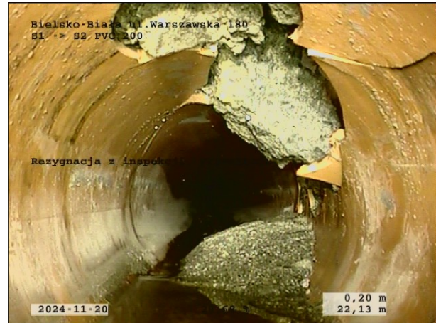
Zdjęcie: 1_2A, 00:03:18 22,13m, Rezygnacja z inspekcji, Przeszkoda
