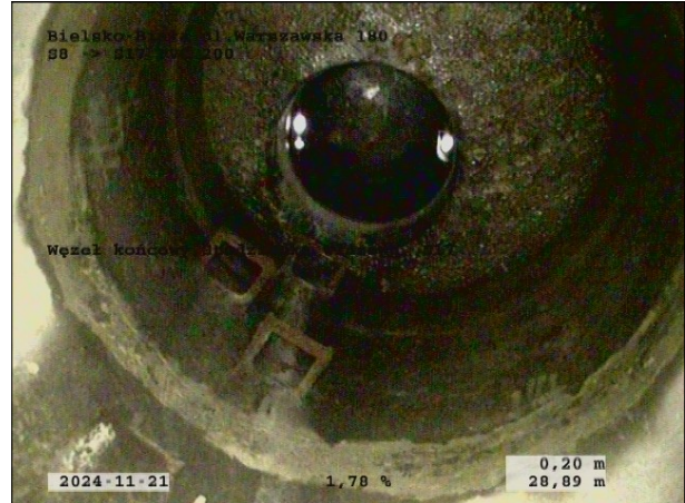
Zdjęcie: 20_2A, 00:02:44 28,89m, Węzeł końcowy, Studzienka włazowa, S17
