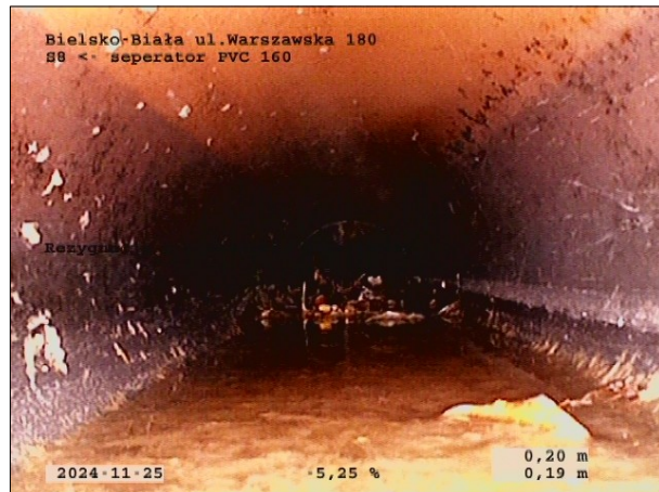
Zdjęcie: 50_1A, 00:00:36 0,19m, Rezygnacja z inspekcji, Przeszkoda
