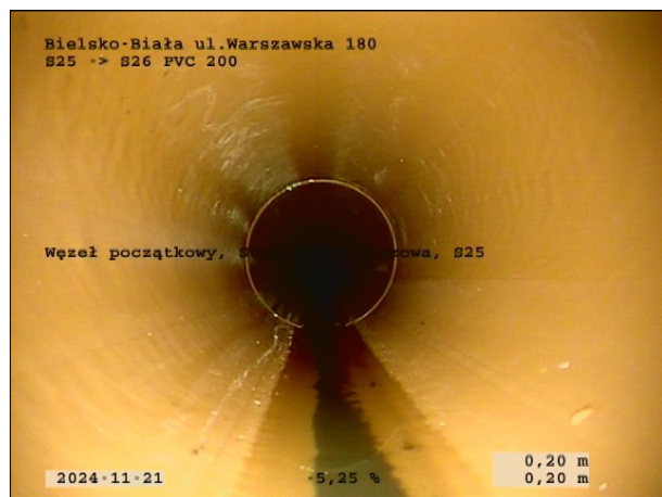
Zdjęcie: 35_1A, 00:00:00 0,2m, Węzeł początkowy, Studzienka włazowa, S25
