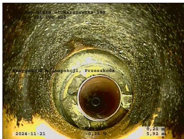
Zdjęcie: 30_2A, 00:02:22 5,92m, Rezygnacja z inspekcji, Przeszkoda
