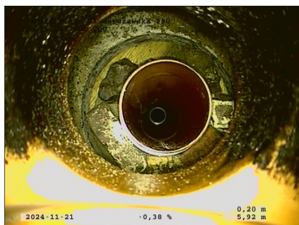
Zdjęcie: 30_2B, 00:02:22 5,92m, Rezygnacja z inspekcji, Przeszkoda
