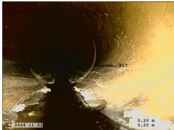
Zdjęcie: 20_1A, 00:00:00 0,2m, Węzeł początkowy, Studzienka włączowa, S17
