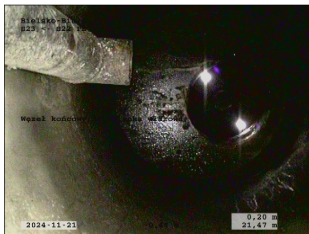
Zdjęcie: 31_2A, 00:01:44 21,47m, Węzeł końcowy, Studzienka włazowa, S22
