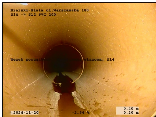
Zdjęcie: 15_1A, 00:00:00 0,2m, Węzeł początkowy, Studzienka włazowa, S14
