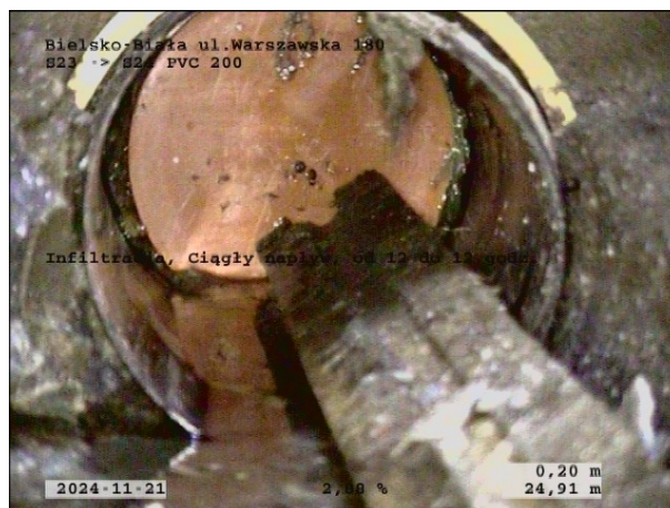
Zdjęcie: 33_2A, 00:02:28 24,91m, Infiltracja, Ciągły napływ, od 12 do 12 godz.
