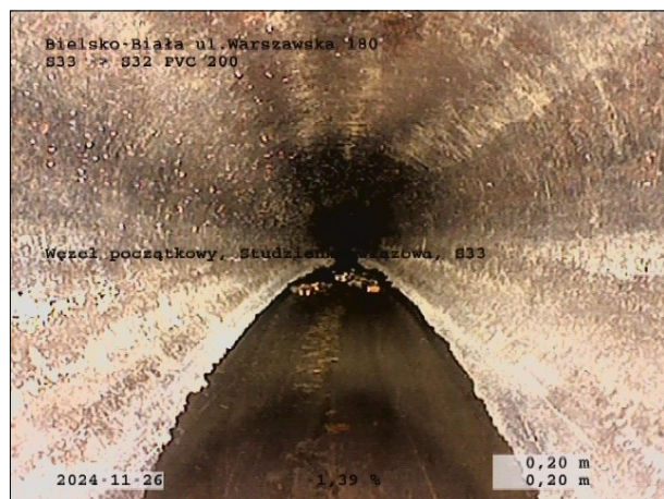
Zdjęcie: 59_1A, 00:00:00 0,2m, Węzeł początkowy, Studzienka włazowa, S33
