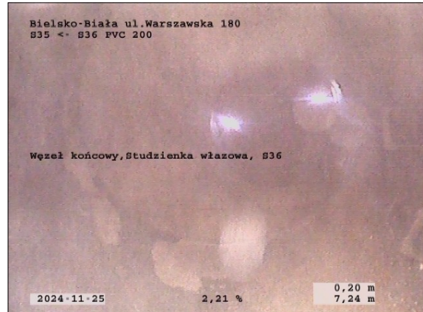
Zdjęcie: 56_2A, 00:01:30 7,24m, Węzeł końcowy, Studzienka włazowa, S36
