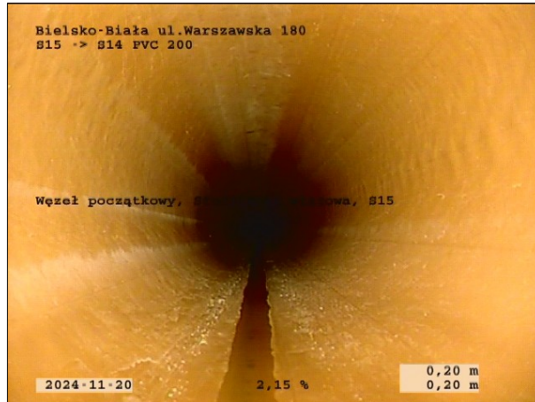
Zdjęcie: 13_1A, 00:00:00 0,2m, Węzeł początkowy, Studzienka włazowa, S15
