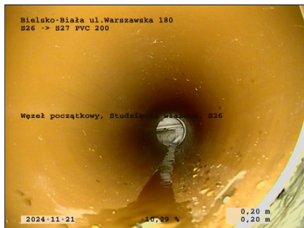
Zdjęcie: 36_1A, 00:00:00 0,2m, Węzeł początkowy, Studzienka włazowa, S26
