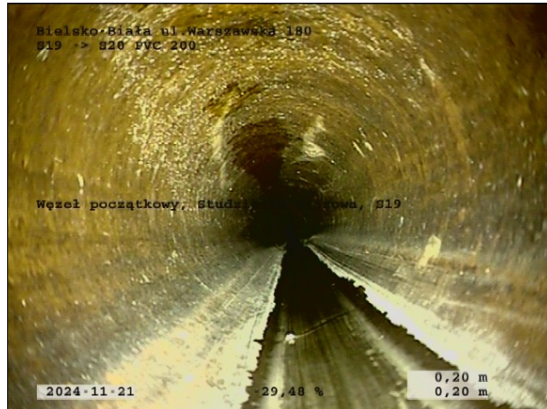
Zdjęcie: 29_1A, 00:00:00 0,2m, Węzeł początkowy, Studzienka włazowa, S19
