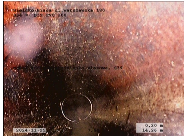
Zdjęcie: 52_2A, 00:01:32 14,26m, Węzeł końcowy, Studzienka włazowa, S39
