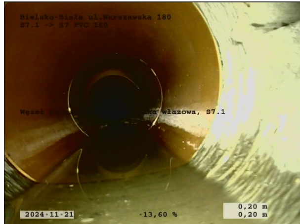
Zdjęcie: 24_1A, 00:00:00 0,2m, Węzeł początkowy, Studzienka włazowa, S7.1
