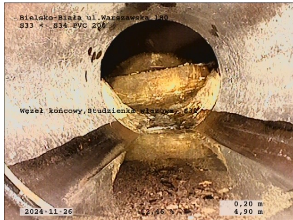
Zdjęcie: 61_2A, 00:00:36 4,9m, Węzeł końcowy, Studzienka włazowa, S34
