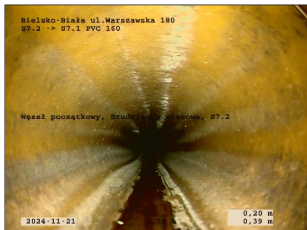
Zdjęcie: 22_1A, 00:00:00 0,39m, Węzeł początkowy, Studzienka włazowa, S7.2
