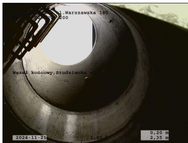
Zdjęcie: 36_2A, 00:00:20 2,35m, Węzeł końcowy, Studzienka włazowa, S27
