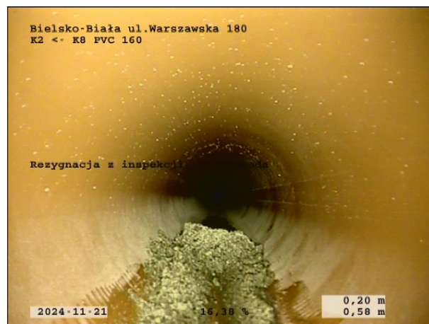
Zdjęcie: 27_2A, 00:00:29 0,58m, Rezygnacja z inspekcji, Przeszkoda
