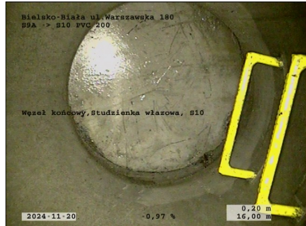
Zdjęcie: 9_2A, 00:01:24 16m, Węzeł końcowy, Studzienka włazowa, S10
