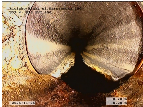
Zdjęcie: 57_1A, 00:00:00 0,2m, Węzeł początkowy, Studzienka włazowa, S37
