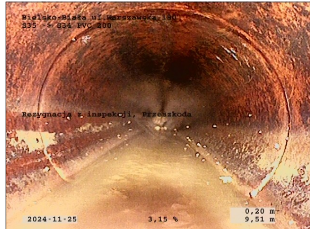
Zdjęcie: 55_2A, 00:00:49 9,51m, Rezygnacja z inspekcji, Przeszkoda
