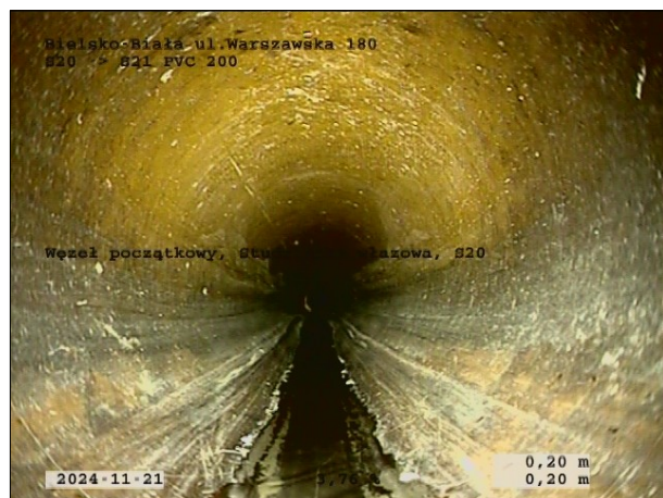
Zdjęcie: 30_1A, 00:00:00 0,2m, Węzeł początkowy, Studzienka włazowa, S20
