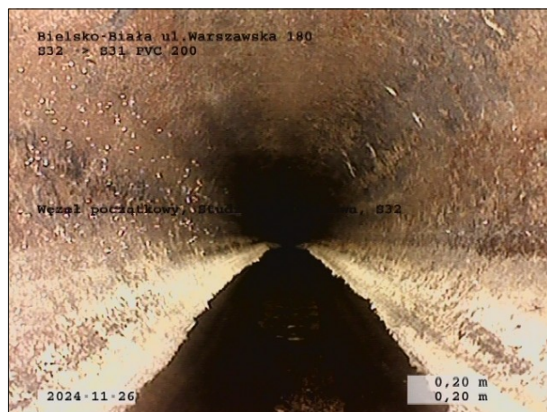
Zdjęcie: 60_1A, 00:00:00 0,2m, Węzeł początkowy, Studzienka włączowa, S32
