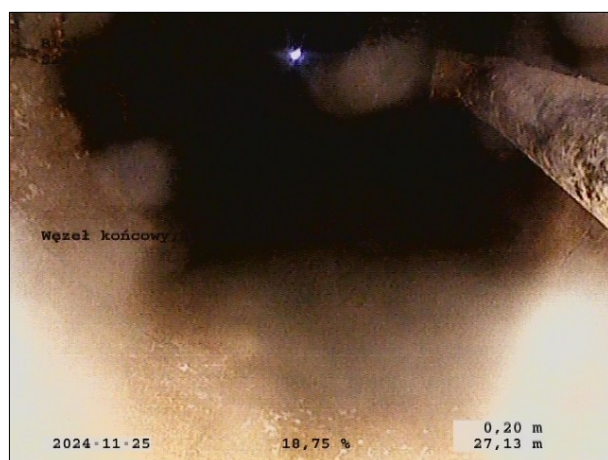
Zdjęcie: 37_3A, 00:02:49 27,13m, Węzeł końcowy, Studzienka włazowa, S22
