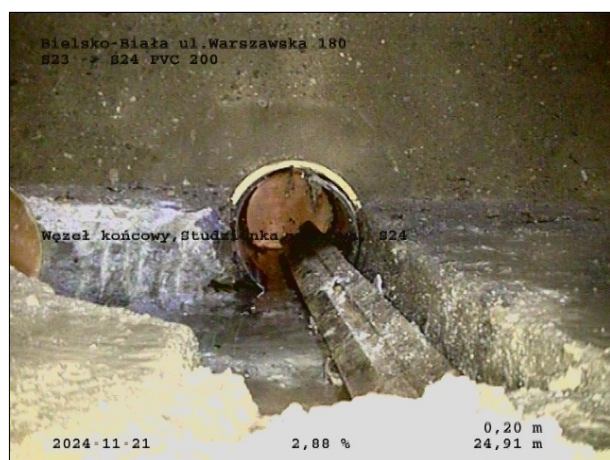
Zdjęcie: 33_3A, 00:02:37 24,91m, Węzeł końcowy, Studzienka włazowa, S24
