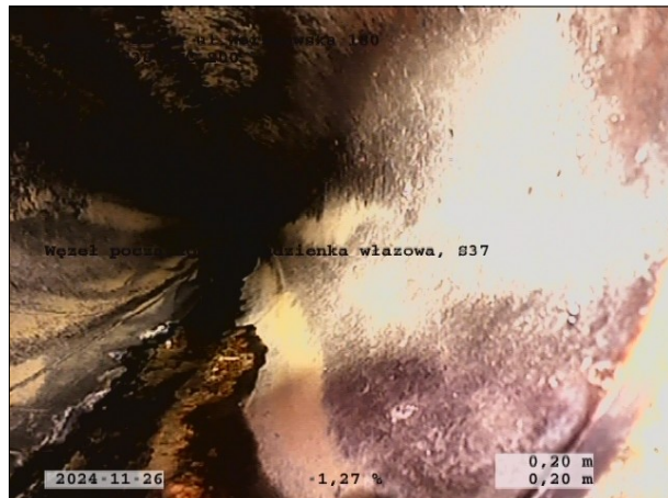
Zdjęcie: 58_1A, 00:00:00 0,2m, Węzeł początkowy, Studzienka włazowa, S37
