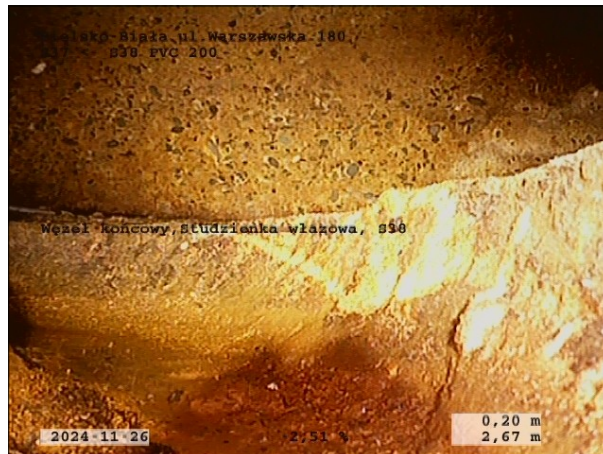
Zdjęcie: 57_2A, 00:00:24 2,67m, Węzeł końcowy, Studzienka włazowa, S38
