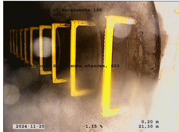
Zdjęcie: 38_2A, 00:01:39 21,3m, Węzeł końcowy, Studzienka włazowa, S23
