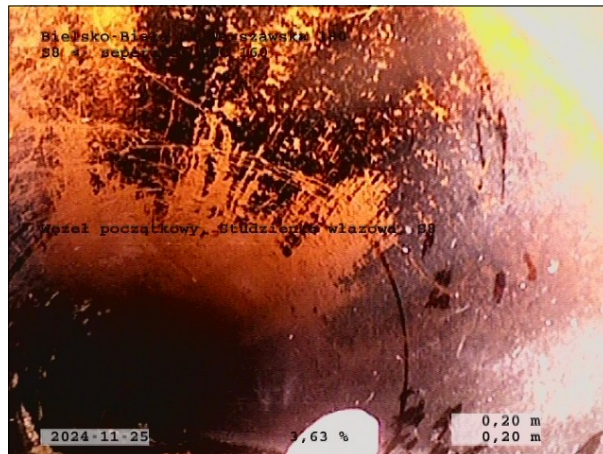
Zdjęcie: 50_1A, 00:00:00 0,2m, Węzeł początkowy, Studzienka wiazowa, S8
