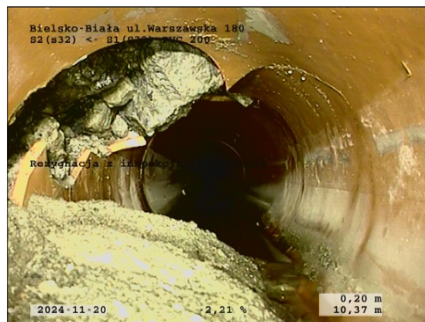
Zdjęcie: 2_2A, 00:01:02 10,37m, Rezygnacja z inspekcji, Przeszkoda
