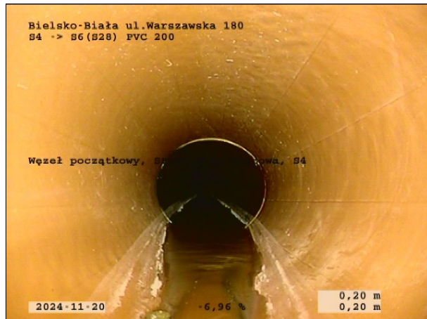
Zdjęcie: 5_1A, 00:00:00 0,2m, Węzeł początkowy, Studzienka włazowa, S4
