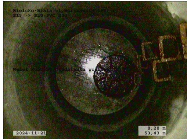
Zdjęcie: 29_2A, 00:04:16 53,43m, Węzeł końcowy, Studzienka włazowa, S20
