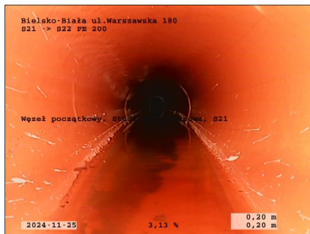
Zdjęcie: 37_1A, 00:00:00 0,2m, Węzeł początkowy, Studzienka włazowa, S21
