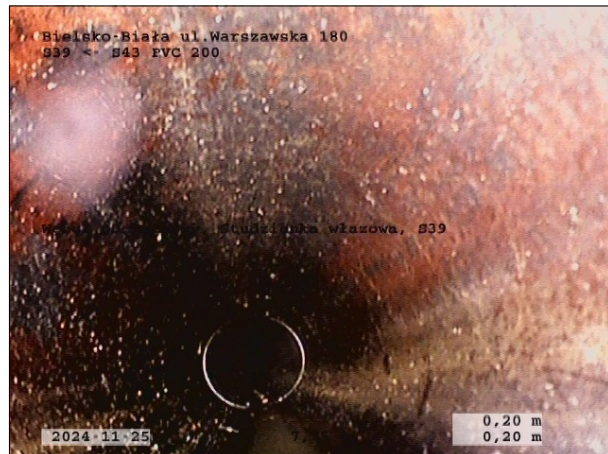
Zdjęcie: 53_1A, 00:00:00 0,2m, Węzeł początkowy, Studzienka włazowa, S39
