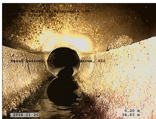
Zdjęcie: 59_3A, 00:03:27 34,63m, Węzeł końcowy, Studzienka włazowa, S32
