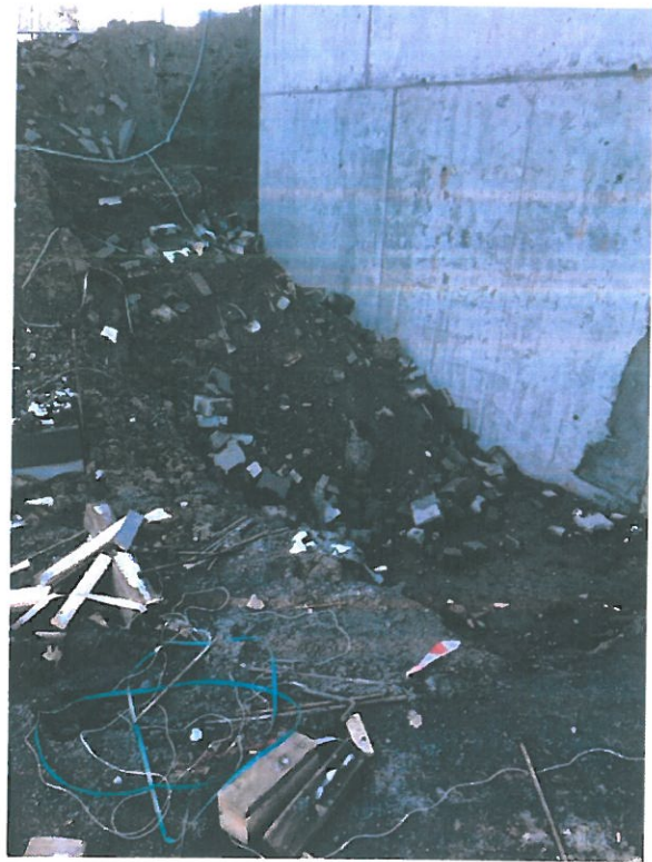
● Zdjęcie 67, Zasypywanie muru oporowego odbywa się nieprawidłowym materiałem z użyciem gruzu – usunąć gruz i zastosować odpowiedni materiał
