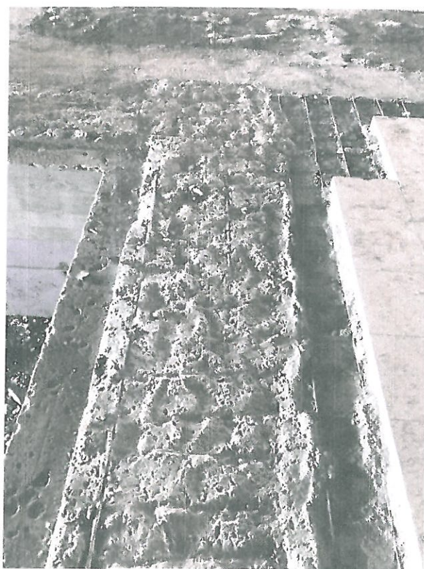
Foto 11 – powierzchnia doku przy KAUFLEND wymaga naprawy
