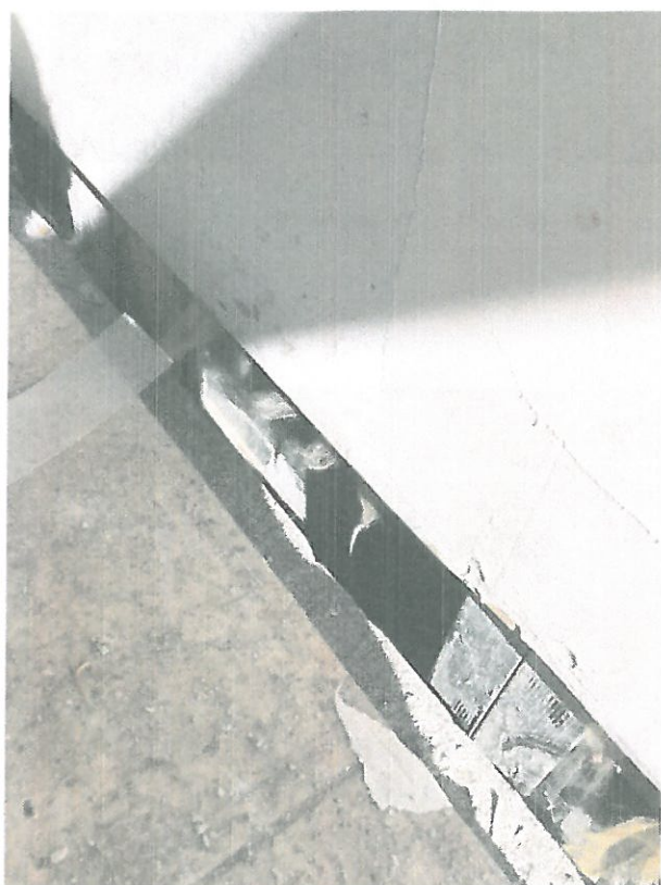
● Zdjęcie 26 – Wypełnić dziurę przy posadzce w pom. technicznym przy lokalach L05
