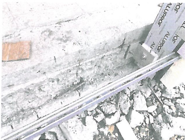
Foto 4 – wycięte zbrojenie w osi C3'. Wymaga potwierdzenia z projektantem i naprawy
