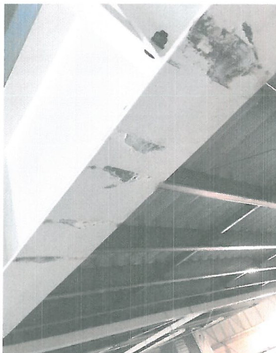
Zdjęcie 2 – Uszkodzenia powłoki malarskiej konstrukcji, dotyczy całej budowy
