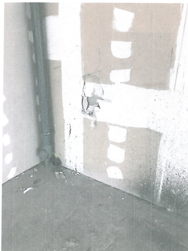
● Zdjęcie 15 – Uszkodzone ściany GW w lokalu L02
