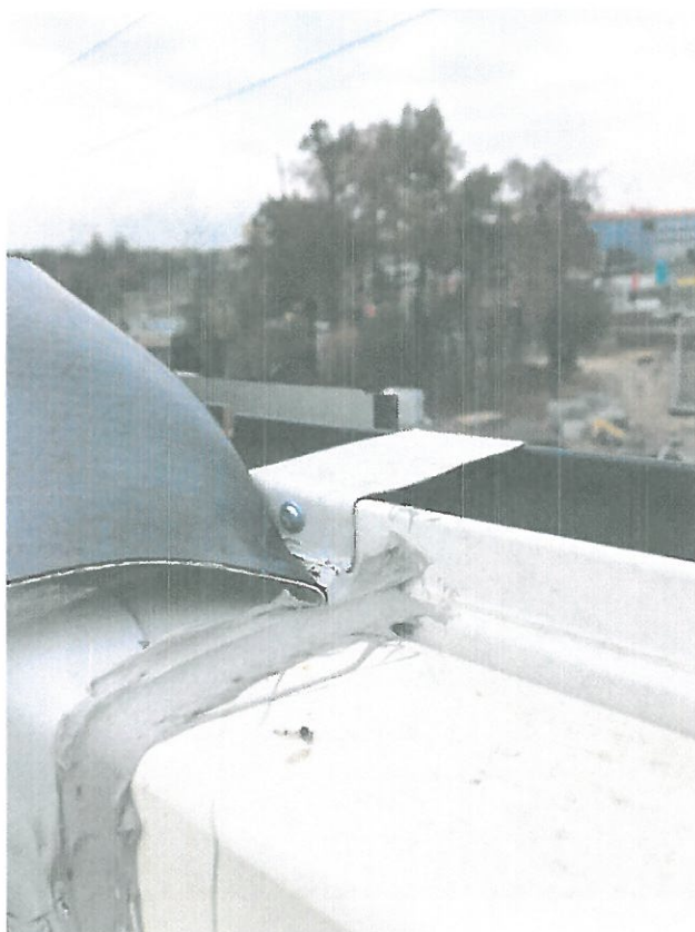
● Zdjęcie 42 – lokalne niedokładności uszczelnienia przy słupach konstrukcyjnych, niedokładności zgrzania membrany
