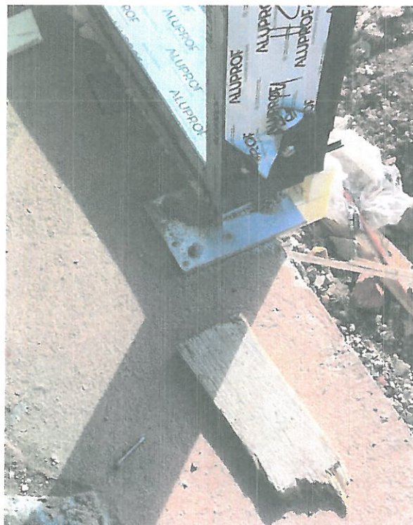
● Zdjęcie 29 – Sposób montażu witryny 1 rozbieżny względem projektu warsztatowego – zgłoszone w email z 23-09-2024.
