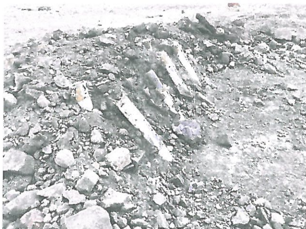
Foto 22 – uszkodzone kotwy w stopie fundamentowej Etap 2. Do czasu wyjaśnienia z Projektantem brak zgody na montaż słupa na tych kotwach.
