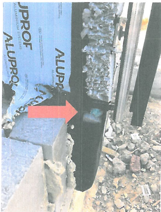
● Zdjęcie 25 – brak uszczelnienia fasad w strefie cokołowej – szczegóły wg odrębnego email
