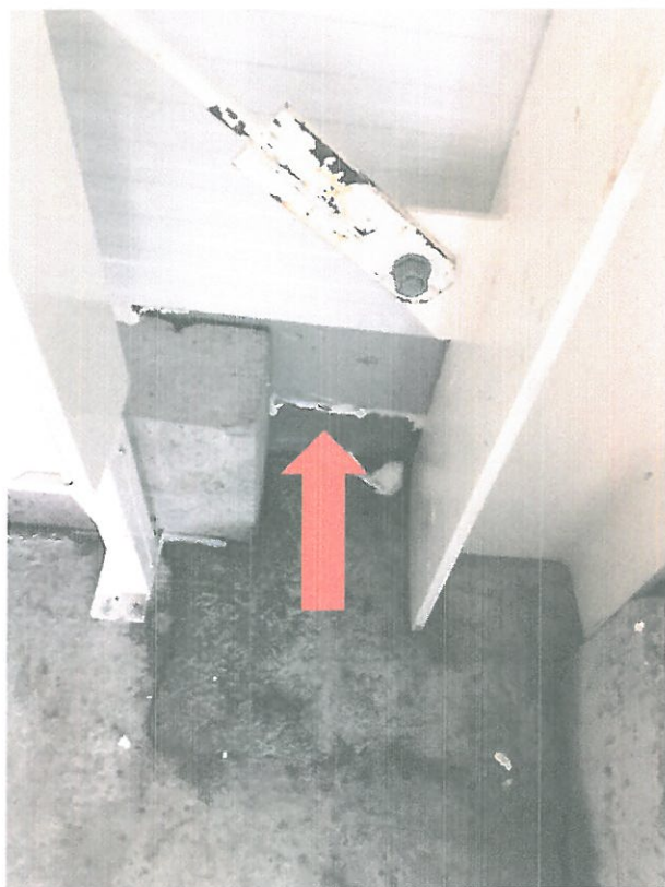
● Zdjęcie 23 – uzupełnić przegrodę budowlaną, Etap w przy narożnikach, aktualnie tylko styrodur
