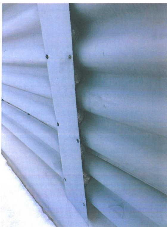
● Zdjęcie 3 – Niedokręcona obróbka, oś H
