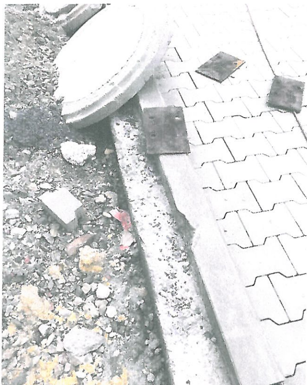
Foto 26 – krawężniki uszkodzone przez składowanie materiału, do wymiany
