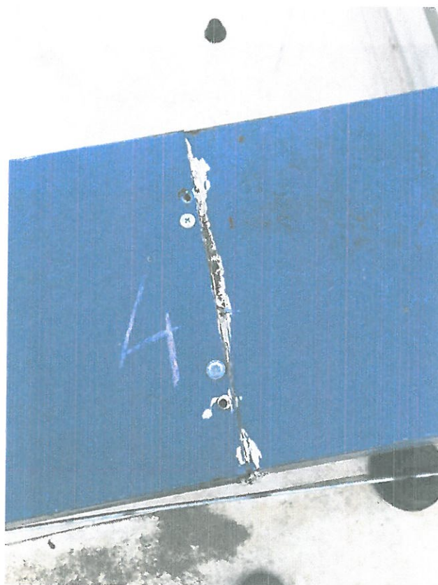
● Zdjęcie 71 – Wkręty do blach na attykach powinny być z uszczelką. Uszczelnić dziury w obróbkach.
