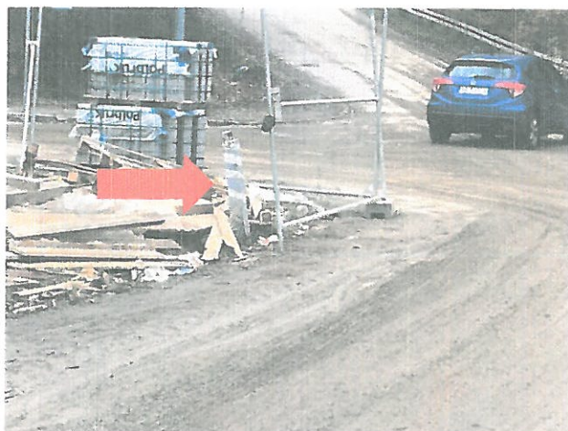
● Zdjęcie 110 – usunąć pozostałości (słupki) po szlabanach
