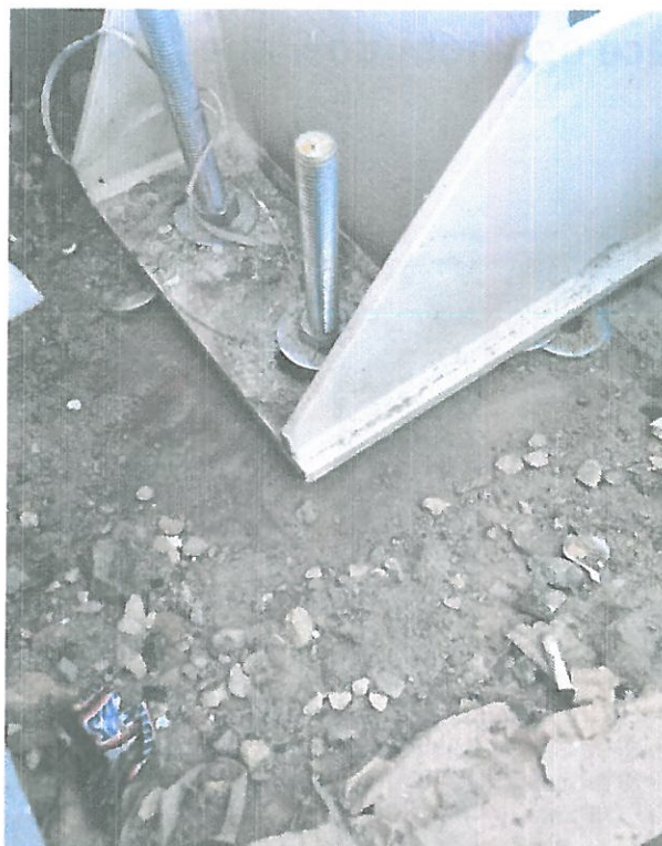
Zdjęcie 14 – Nie wymieniono podkładek na kotwach słupów stalowych Etap 2 – zgłaszano w poprzednim raporcie i na formularzu RFI.
