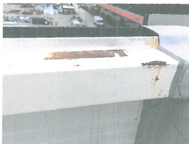
● Zdjęcie 79 – Skorodowana nowa konstrukcja attyk – oczyścić i pomalować zgodnie z Umową
