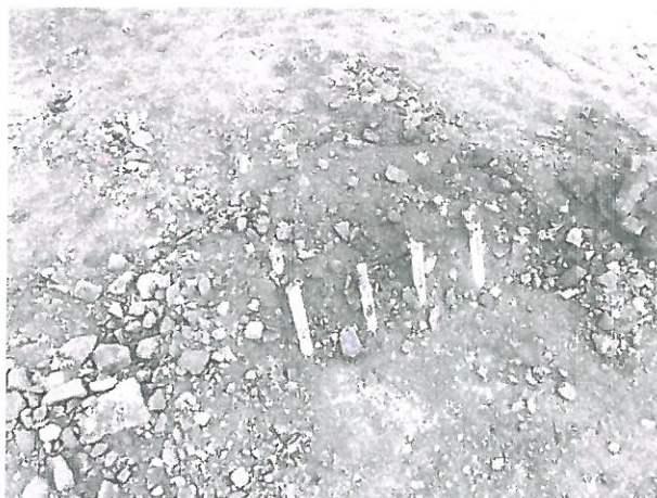
Foto 21 – uszkodzone kotwy w stopie fundamentowej Etap 2. Do czasu wyjaśnienia z Projektantem brak zgody na montaż słupa na tych kotwach.
