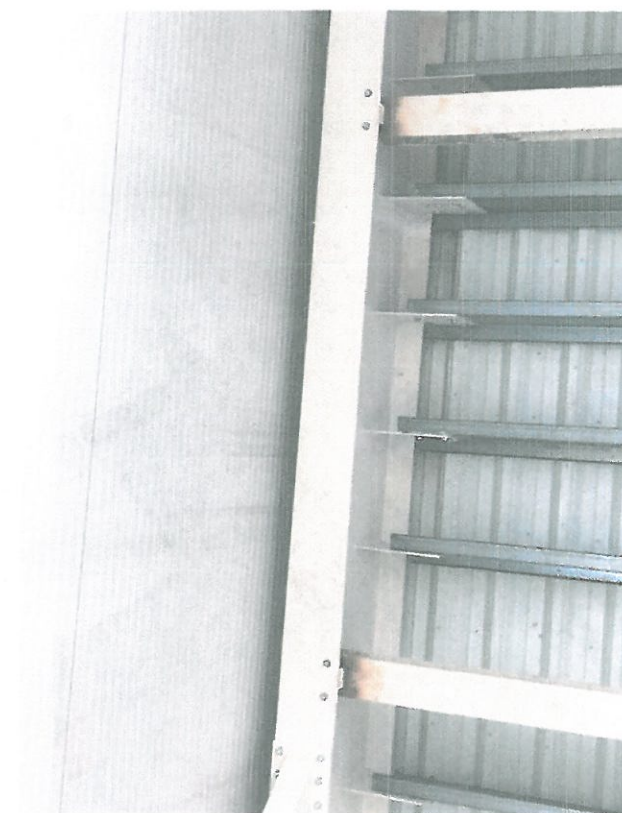
● Zdjęcie 26 – Nadal na budowie występują niepomalowane elementy konstrukcji stalowej. Należy niezwłocznie uzupełnić powłoki malarskie.
