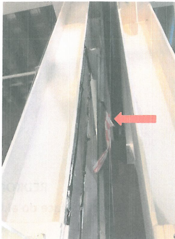
● Zdjęcie 2 – Usunąć pozostałości po rozbiórkach – luźna blacha trapezowa, lokalizacja KAUF LAND przy dylatacji konstrukcyjnej
