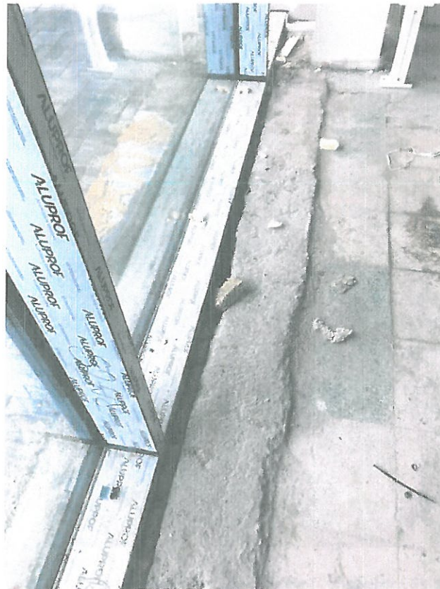
● Zdjęcie 10 – Uzupełnić i wyrównać posadzki w niewynajętych lokalach
