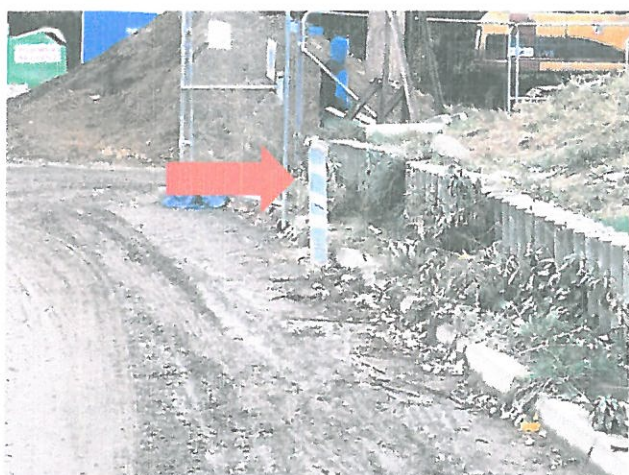
● Zdjęcie 111 – usunąć pozostałości (słupki) po szlabanach
