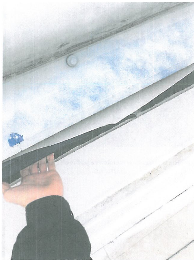
● Zdjęcie 65 – Luźna, nieprzymocowana blacha na styku dachów o różnej wysokości nad KAUFLAND
