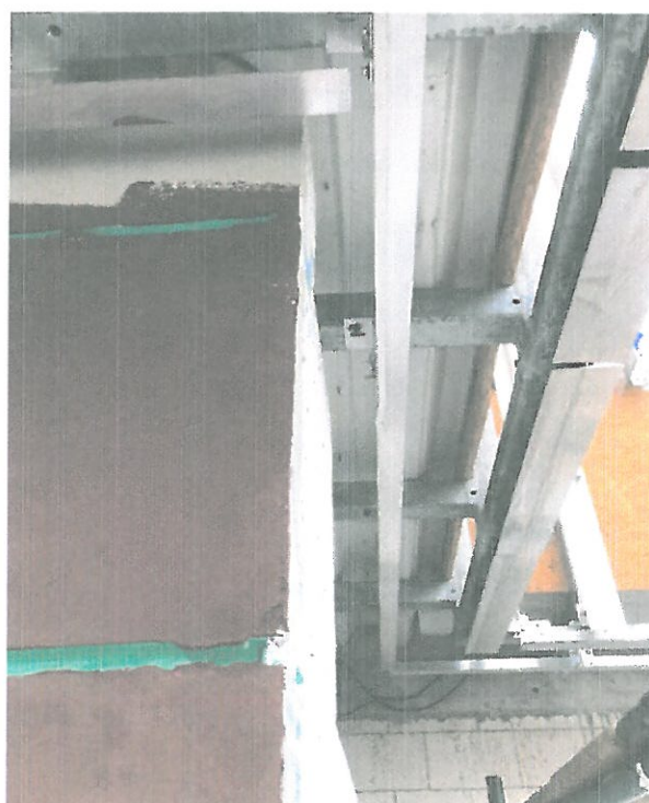
Zdjęcie 115 – Uzupełnić przekładki pomiędzy aluminium podkonstrukcją obudowy elewacji a konstrukcją stalową
