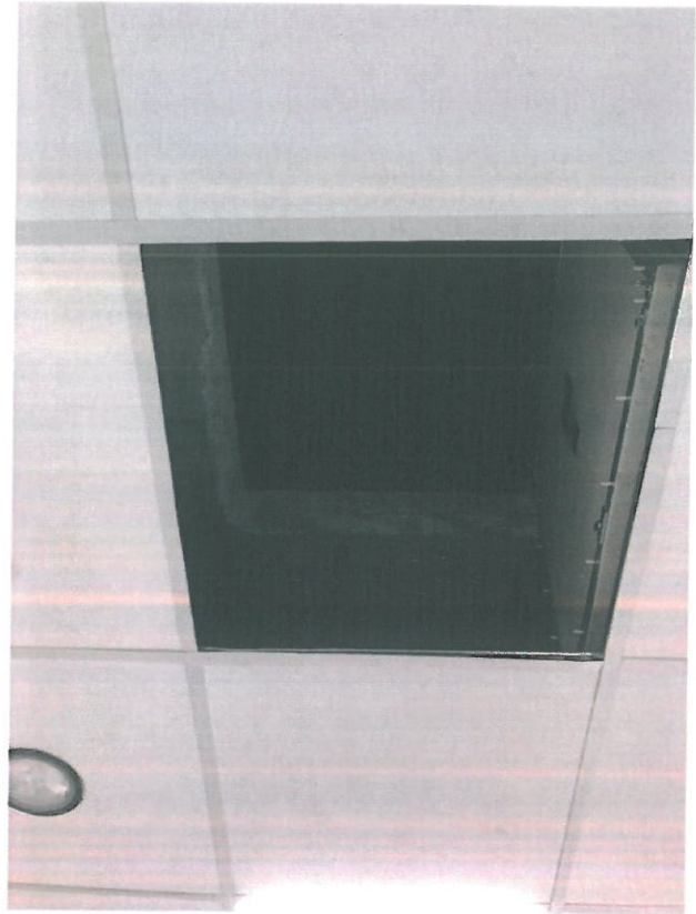
● Zdjęcie 52, Brak schodów na strop nad pom. security T.02, zgodnie z projektem
