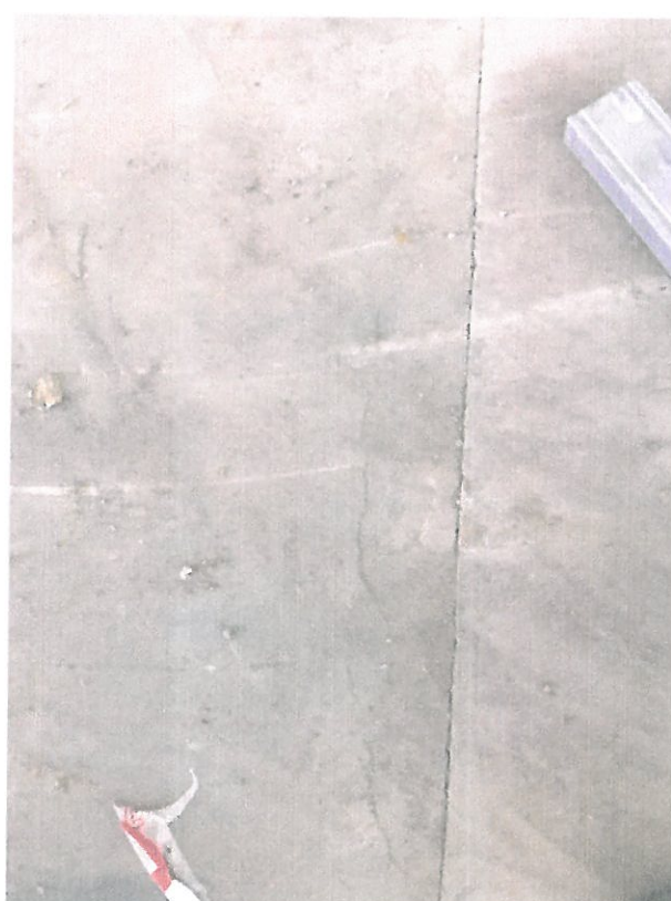
Foto 19 – spękana posadzka lokalu L10 (MARTES SPORT)
