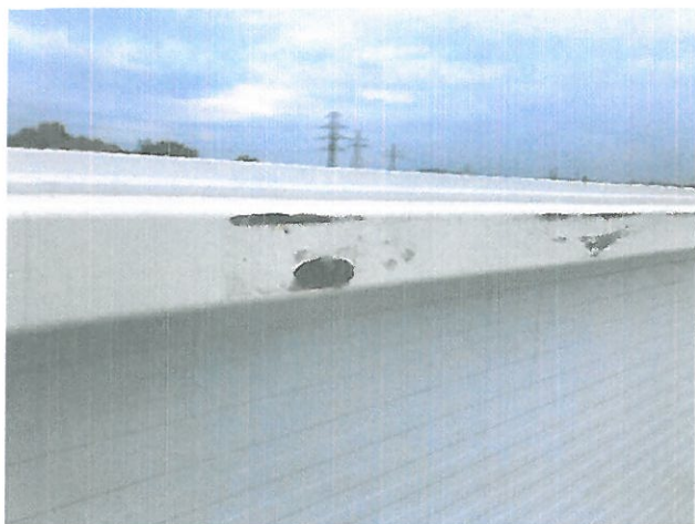
● Zdjęcie 82 83 – Skorodowana nowa konstrukcja attyk – oczyścić i pomalować zgodnie z Umową
