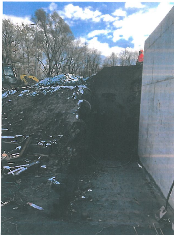
● Zdjęcie 59, Brak zgłoszenia do odbioru zbrojenia i szalunku muru oporowego
