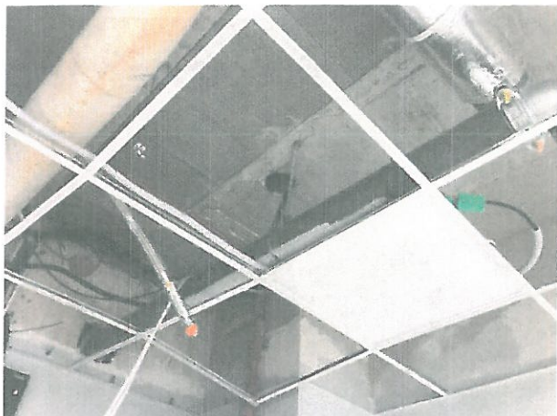
● Zdjęcie 102 – Wykonać niezbędne przejścia pożarowe w pomieszczeniach T.02 SECURITY
