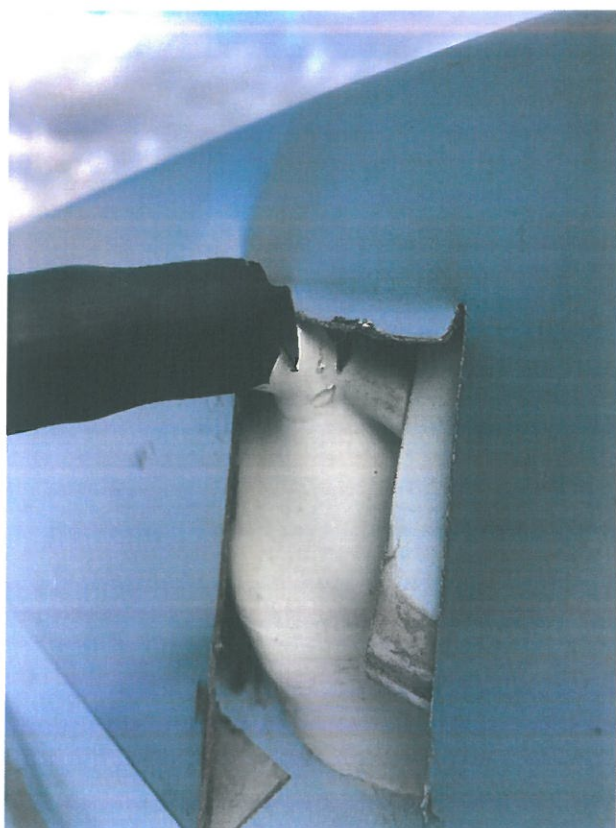
● Zdjęcie 19, Nieszczelność – uszkodzenie kołnierza uszczelniającego pręt inst. odgromowej, oś E
