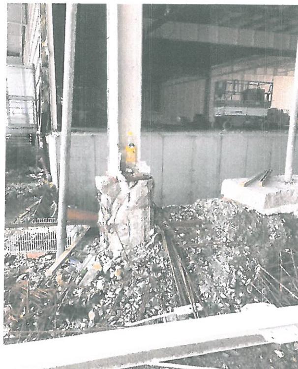
Foto 13 – konieczne monitorowanie stateczności słupa w doku KAUFLAND w celu zachowania bezpieczeństwa. Należy jak najszybciej wykonać docelową konstrukcję a do tego czasu zapewnić aby nie doszło do awarii.
