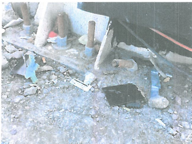
● Zdjęcie 21 – Uszkodzona kotwa (oś 11)
