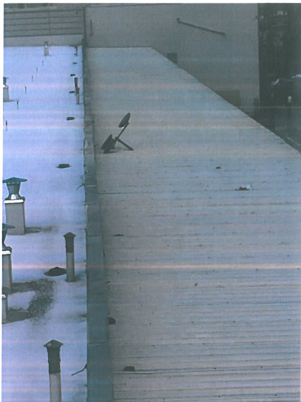
● Zdjęcie 17, Usunąć pozostałości instalacji po demontażu
