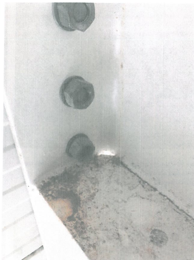
Zdjęcie 12 – Za krótkie śruby montażowe – do wymiany. Przykładowa lokalizacja na zdjęciu, oś 11, lokal L13. Należy wymienić wszystkie śruby o nieprawidłowej długości.
