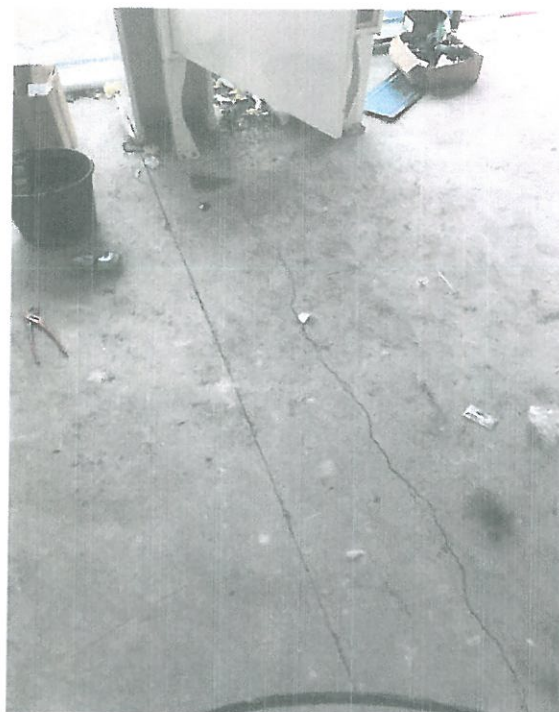
● Zdjęcie 14 – Pęknięcie posadzki w lokalu L.05d. Należy naprawić i wykonać dylatację wzdłuż dylatacji konstrukcyjnej budynku.
