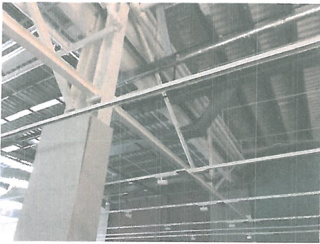
● Zdjęcie 5 – Konieczność potwierdzenia z projektantem modyfikacji geometrii stężenia portalowego (KAUFLAND) – zmieniono lokalizację zastrzału z uwagi na kolizję
