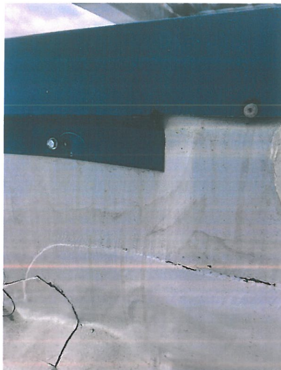
● Zdjęcie 10, Ostra krawędź wrzyna się w membranę, powodując jej uszkodzenie
