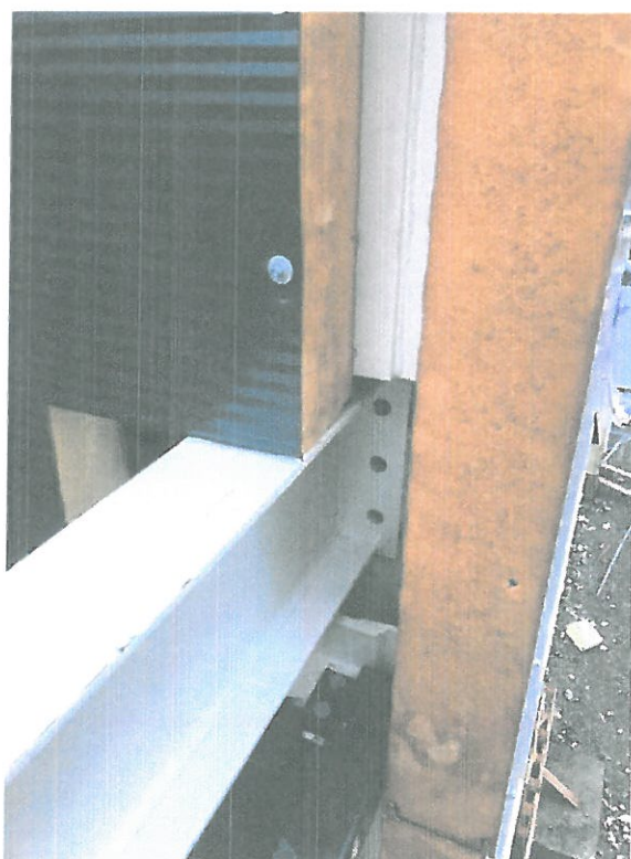
● Zdjęcie 15 – Brak łączników w profilu zadaszenia, Etap 2, zachodnia strona budynku
