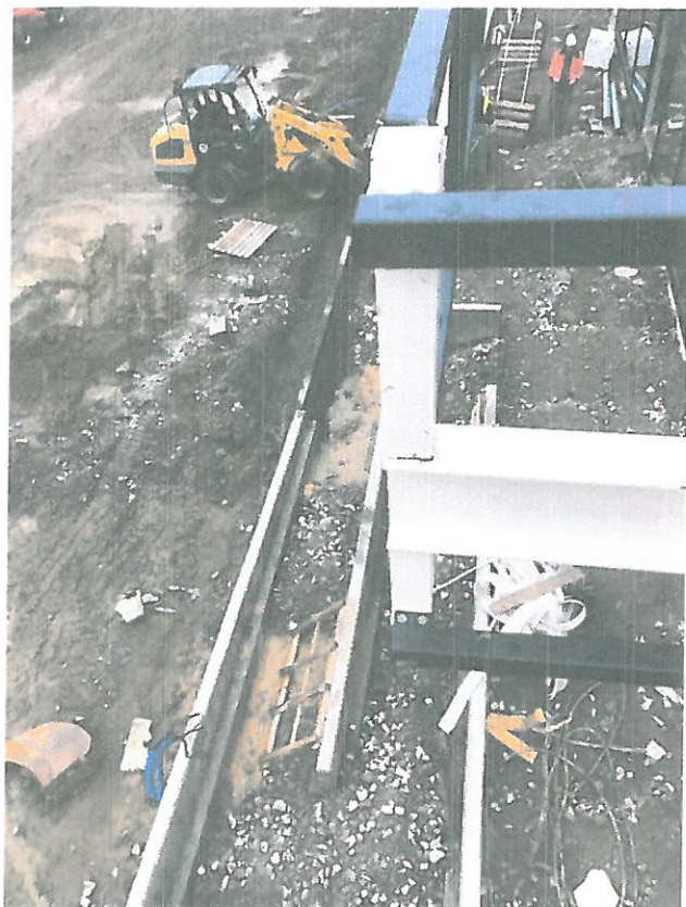
● Zdjęcie 13 – przekięty słupek podkonstrukcji zadaszenia, Etap 2 strona zachodnia budynku
