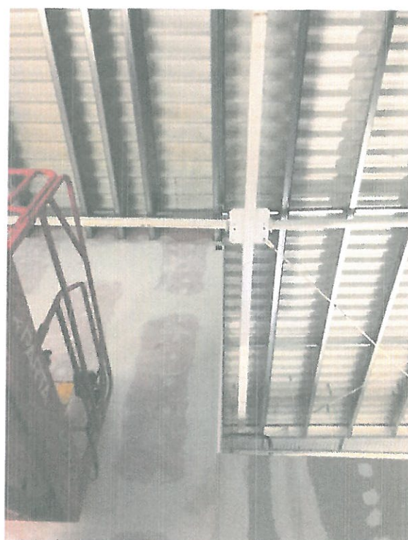
Zdjęcie 16 – Brakujące stężenia połączeniowe, dotyczy całej budowy
