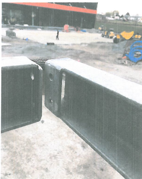
● Zdjęcie 114 – Zbyt krótka konstrukcja w narożniku zadaszenia, brak skrócenia.
