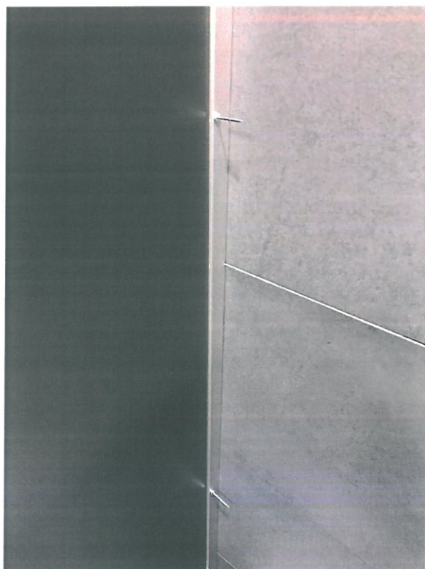
● Zdjęcie 39, Nieukończone i pozostawione nity w kabinie toaletowej męskiej WYKONANO
