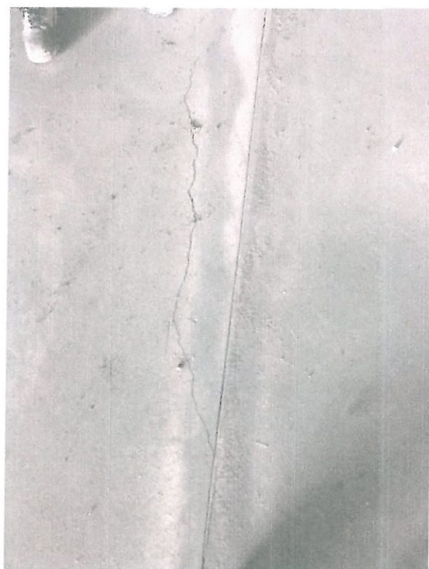
Foto 18 – spękana posadzka lokalu L10 (MARTES SPORT)
