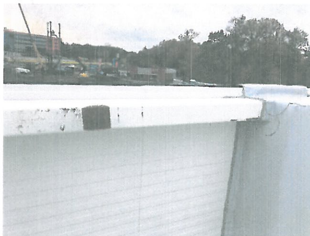
● Zdjęcie 84 85 – Skorodowana nowa konstrukcja attyk – oczyścić i pomalować zgodnie z Umową
