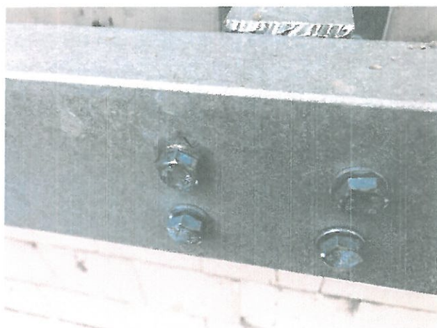
Zdjęcie 38 – Niedokręcone profile konstrukcji zadaszeń – zgłoszone na budowie
