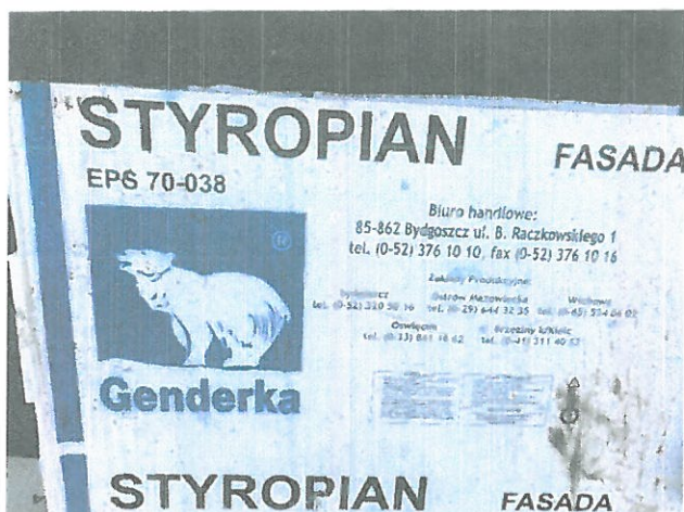
● Zdjęcie 36 – Niezgodność z projektem. Na elewację zastosowano styropian EPS 70, w projekcie jest EPS 80.
