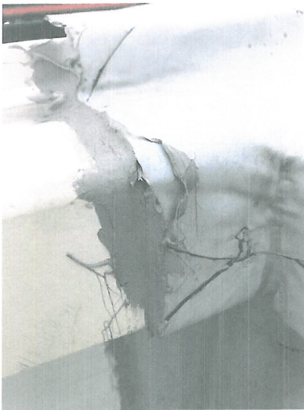
● Zdjęcie 40 – lokalne niedokładności uszczelnienia przy słupach konstrukcyjnych
