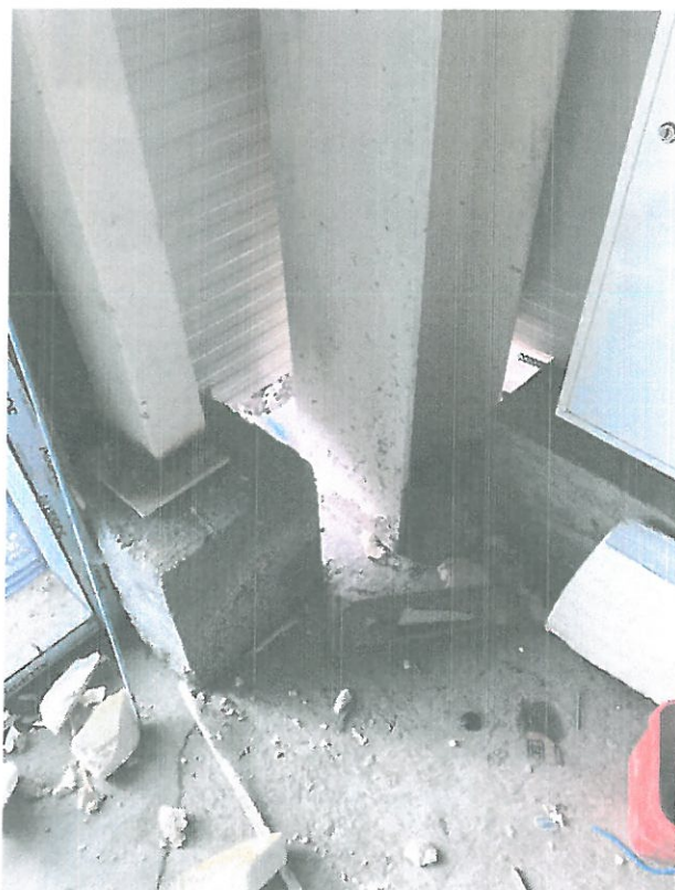
● Zdjęcie 21 – Brak przegrody w narożniku. Lokal L01.
