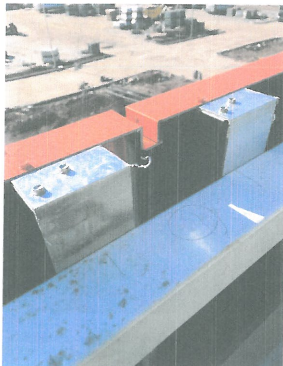
Zdjęcie 96 – Brak przekładek pomiędzy aluminiową podkonstrukcją płyt kompozytowych a konstrukcją stalową
