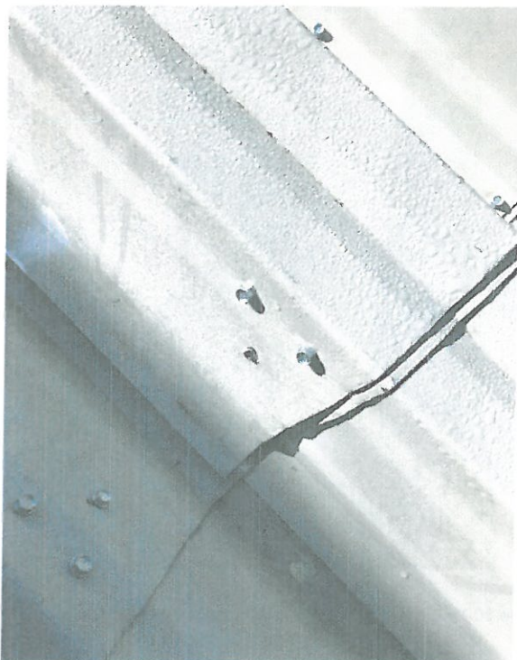
Zdjęcie 95 – Uzupełnić wszelkie brakujące łączniki (zgłoszono na budowie)
