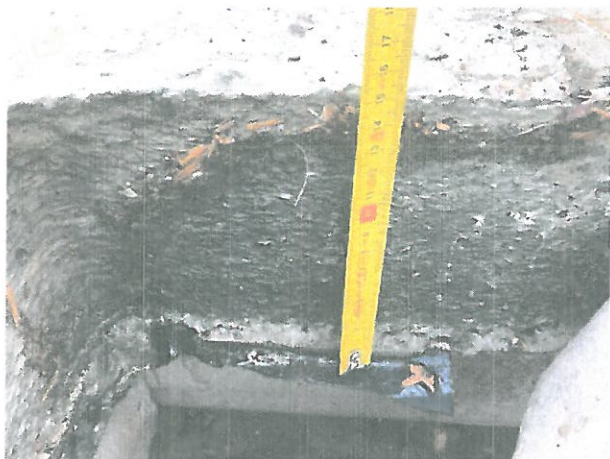
● Zdjęcie 16 – Grubość płyty posadzki Etap 2 mniejsza niż w projekcie. W żadnym pomierzonym punkcie posadzka nie miała 16 cm grubości, jak określono w projekcie. Tutaj wg pomiaru 15 cm.
