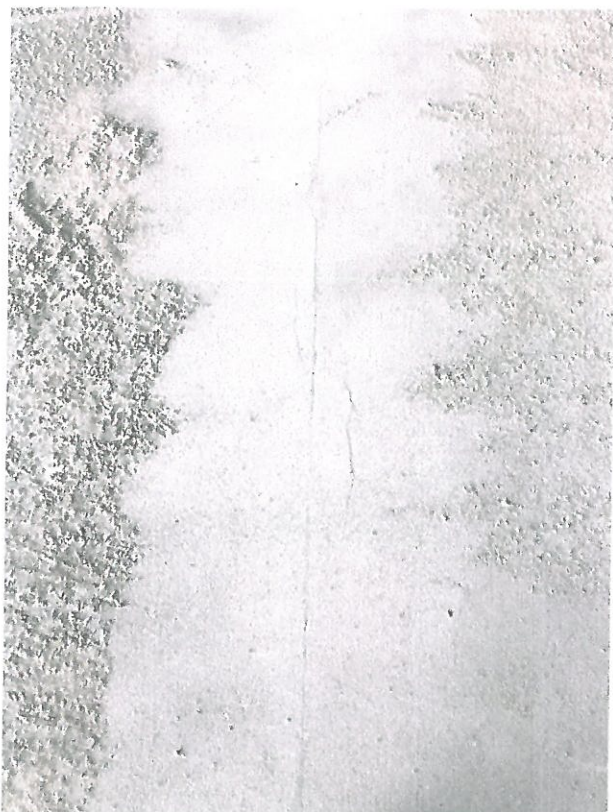
Foto 16 – spękana posadzka lokalu L10 (MARTES SPORT)
