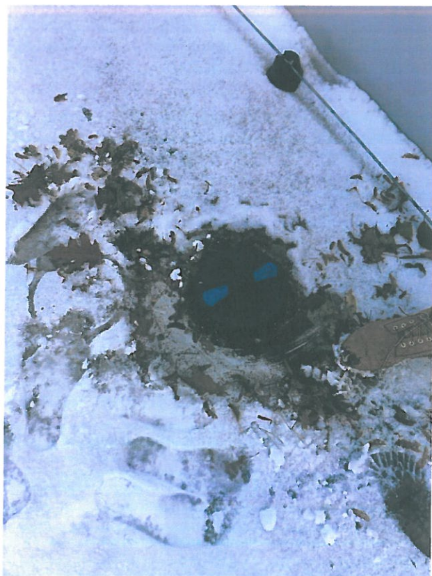
● Zdjęcie 15, Oczyszczyć wszystkie wpusty (również na dachu BURGER KING)
