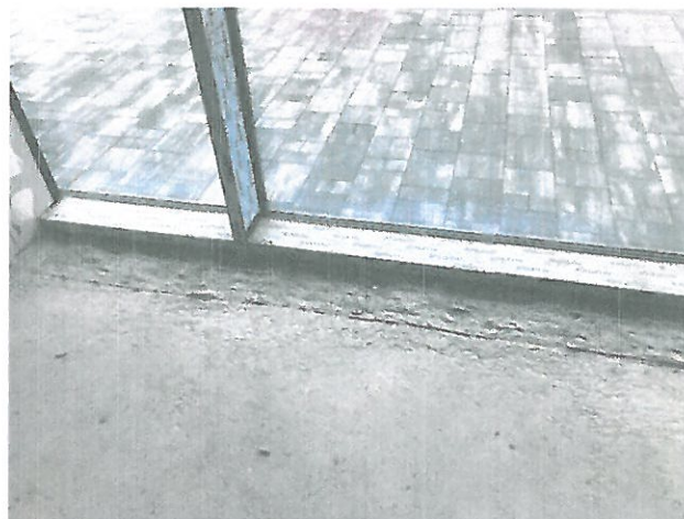
● Zdjęcie 28 – Nierówności posadzki i wystające zbrojenie podwalin. Lokale L20, L21.
