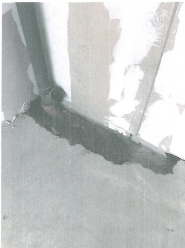
● Zdjęcie 11 – Uzupełnić posadzkę w lokalu L.05d
