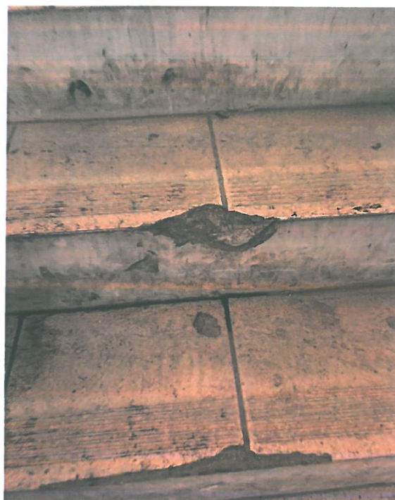
Zdjęcie 44, Wykonać naprawy uszkodzeń schodów w budynku technicznym
