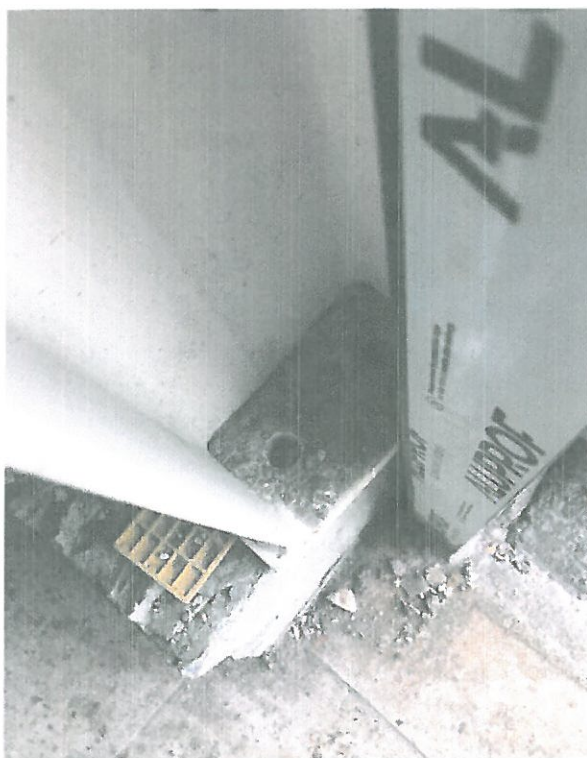
● Zdjęcie 3 – Brak mocowania konstrukcji stalowej do podwaliny. Korytarz do lokalu L09a
