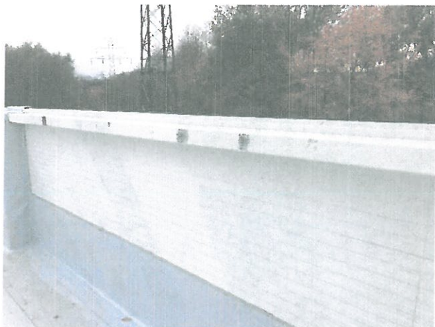
● Zdjęcie 86 – Brak opierzenia (obróbki) attyk i przelewów awaryjnych zgodnie z projektem.
