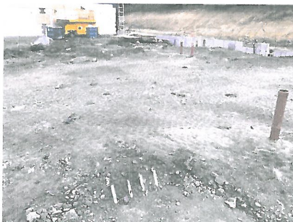
Foto 23 – uszkodzone kotwy w stopie fundamentowej Etap 2. Do czasu wyjaśnienia z Projektantem brak zgody na montaż słupa na tych kotwach.
