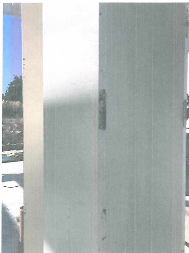
● Zdjęcie 15 – liczne uszkodzenia powłoki malarskiej (Etap 1 i Etap 2)
