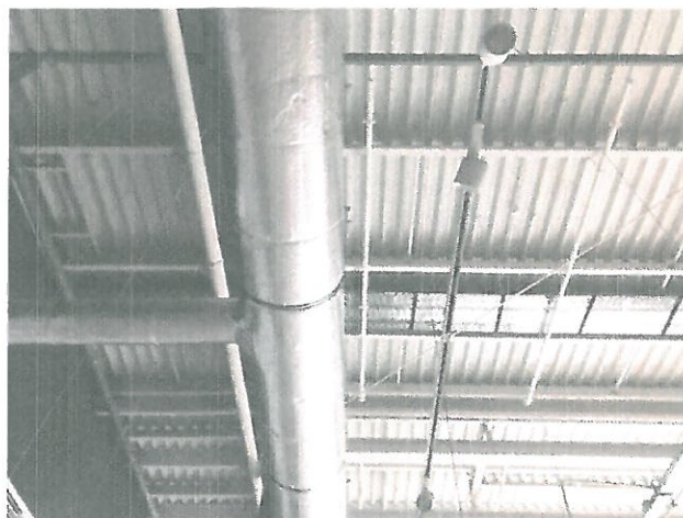
Zdjęcie 12 – brak stężenia połaciowego nad JYSK, szczegóły w odrębnym email
