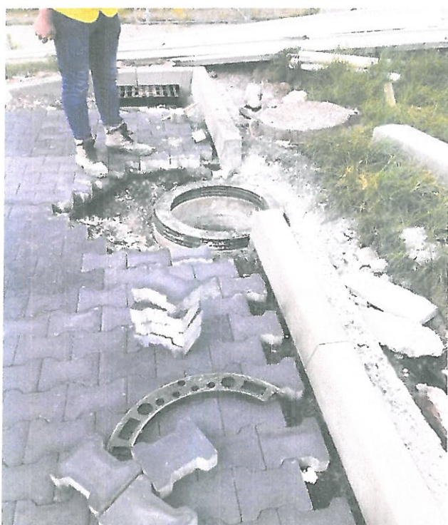
Foto 28 – proszę wyjaśnić lokalizację studni w krawężniku. W projekcie nie wypada w krawężniku.
