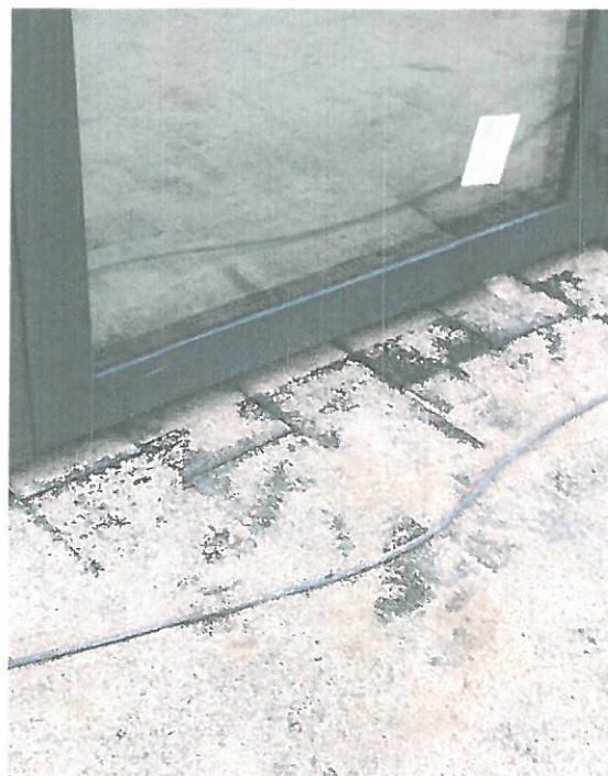
● Zdjęcie 32 – do wyjaśnienia wysokość montażu drzwi. Aktualnie występuje duża szpara pod skrzydłami drzwi. Docelowo nie może być takiej przestrzeni ani progu.
