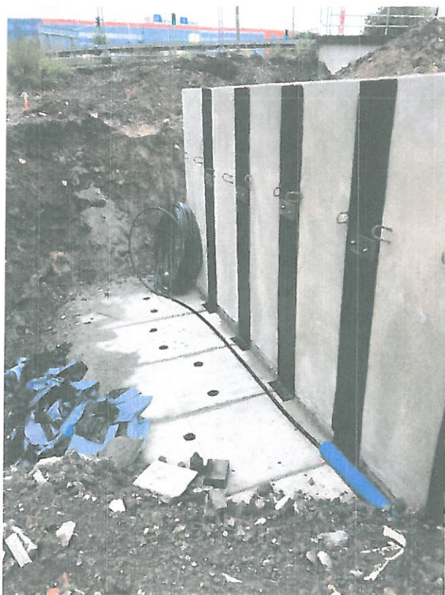
Zdjęcie 42 – proszę dostarczyć protokoły z badania podłoża pod mur oporowy oraz stwierdzeniem zgodności z projektem
