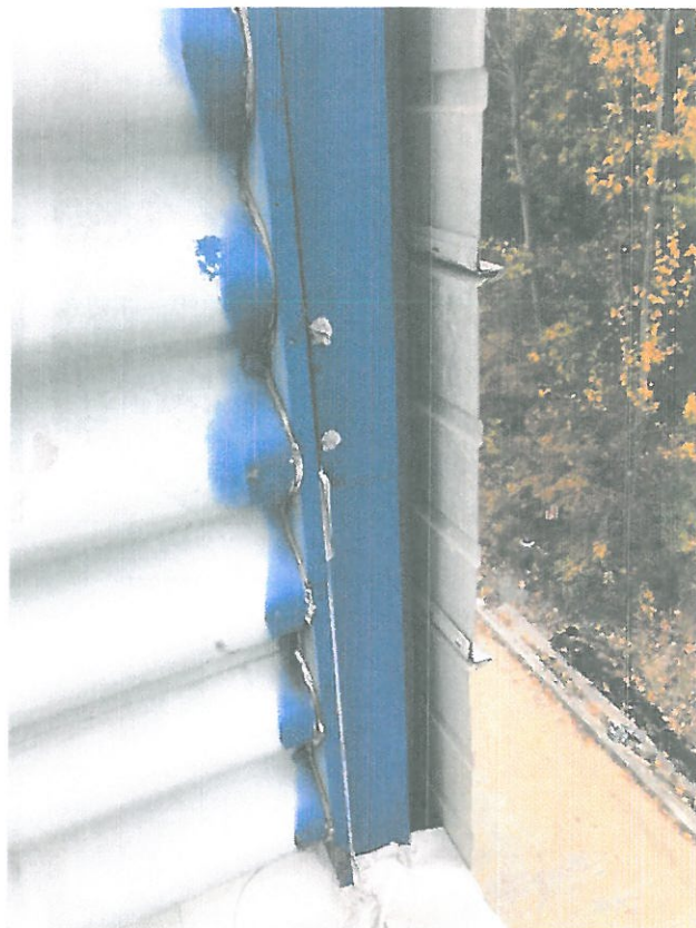
● Zdjęcie 81 – Niezakończony fragment ściany zewn. – Etap 1, oś 14 na styku dachów o różnej wysokości
