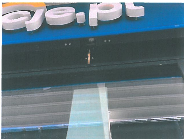
Zdjęcie 29, Na ścianach osłonowych występują liczne braki w obróbkach – przykład nad witryną lokalu WAKACJE.PL. Aktualnie utrudniony dostęp.
