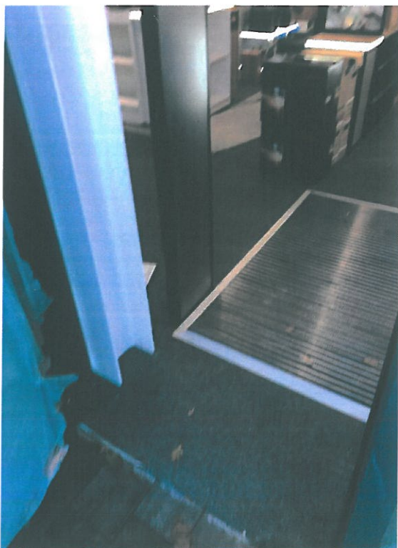
Zdjęcie 60, Liczne uskoki w progach wejściowych do lokali handlowych. Należy wyrównać poprzez regulację wys. kostki lub w inny uzgodniony sposób
