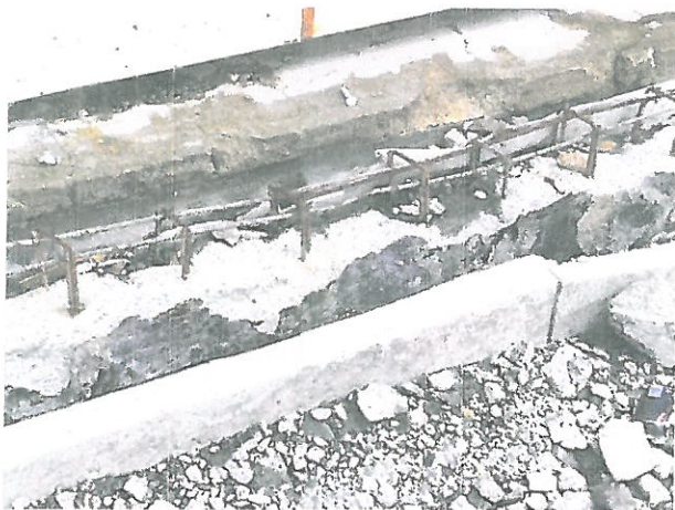
Foto 8 – wygięte pręty w podwalinie, oś P – do wymiany
