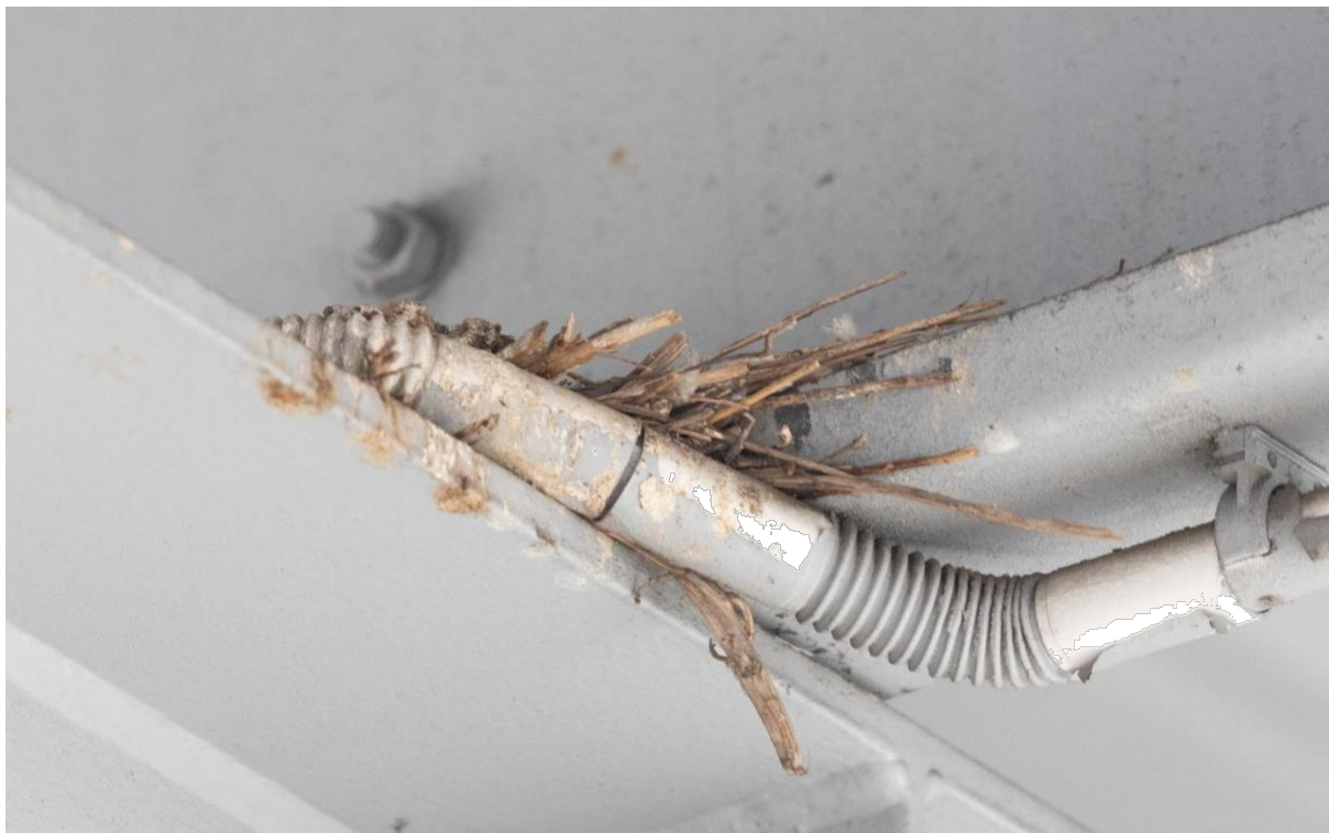
Foto 3. Jedno z 4 nieaktywnych gniazd.
