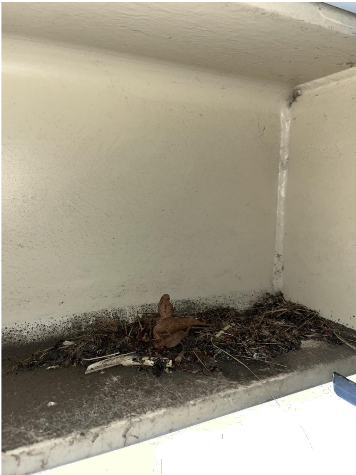
Foto. 8. Pozostałości po gnieździe znalezionym na dachu budynku.
